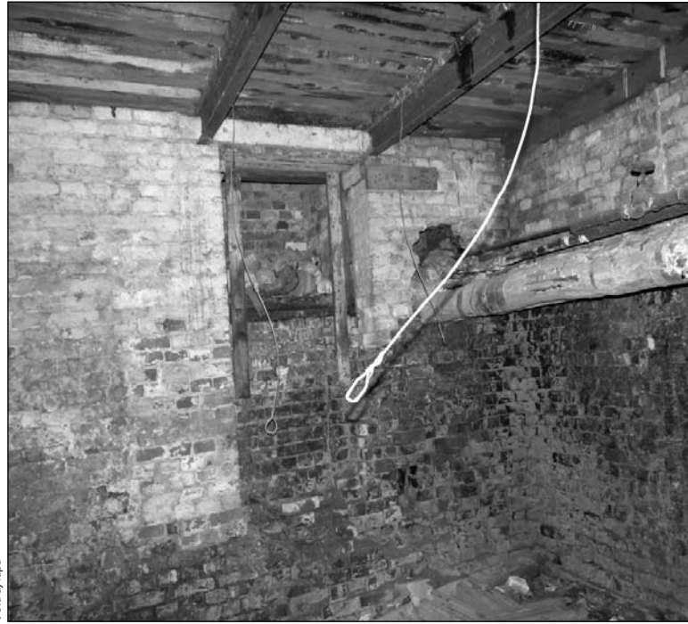
Замураваны выхад за фундамент пад будынкам на Машэрава, 50
